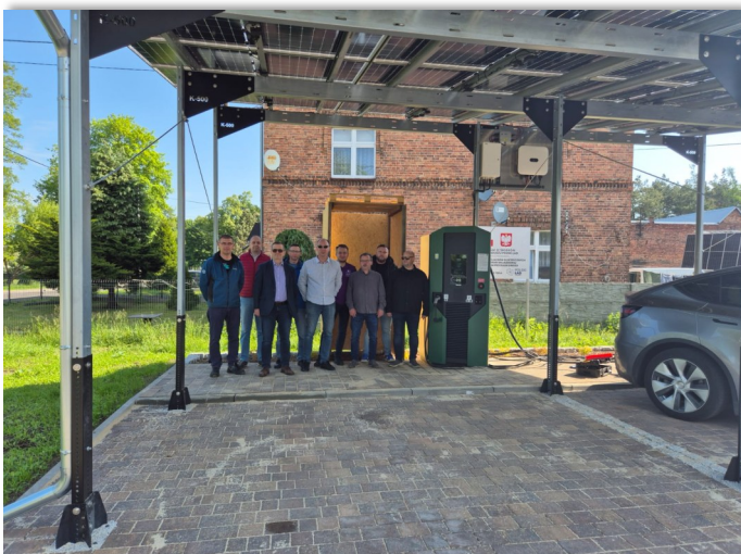
Stacja ładowania pojazdów
